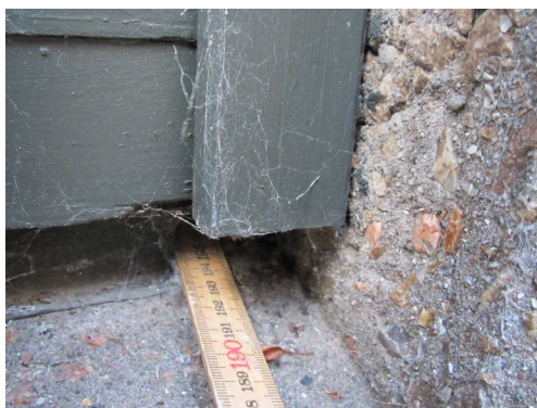
Skade 1 – bundfuge defekt. Type 11.
