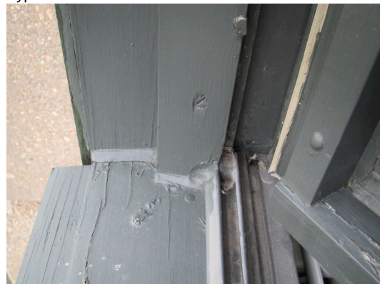
Skade 1 – fugetætning ved samling i karm/bundstykke . Type 12.
