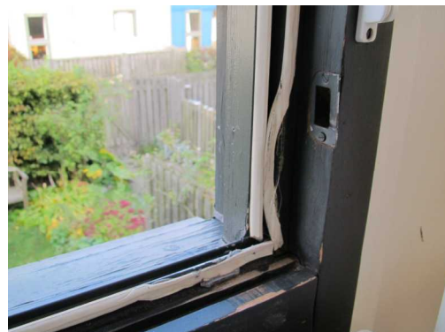
Skade 2 – beskadiget tætningsliste. Type 10.
