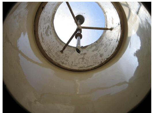
Kuppelovenlys, bad II (B) med kondens og skimmel
