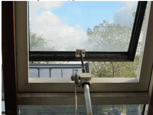
Type AV- Ateliérvindue. Spindellukke. Tilsmudsning/skimmel pga af kondens.
