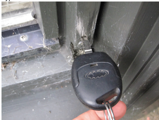
Skade 1 – nedbrudt træværk Type 10.
