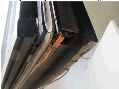
Skade 2 – underside af ramme, og tætningsliste, er beskadiget som følge af at døren binder. Type 12.
